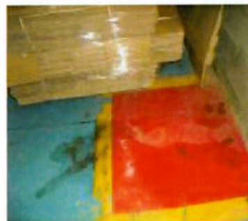
Figura 4 – Poça de água com sujeira na área de Almoxarifado.
